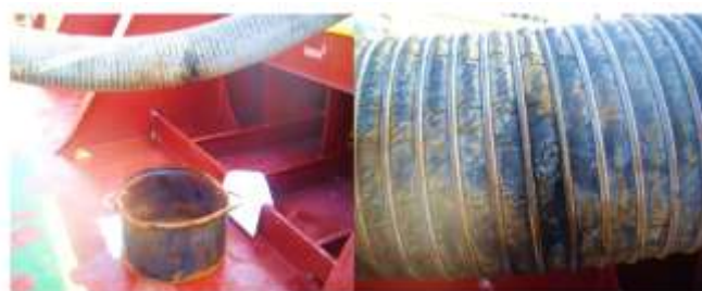
Gambar 1. Rembesan atau kebocoran tangki sebagai salah satu faktor penyebab losses
